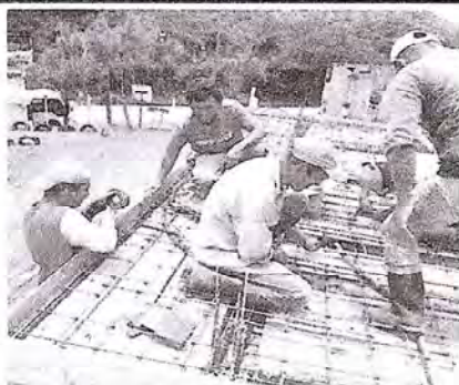
Foto1: Se observa el emparillado de la terraza de los sanitarios.
