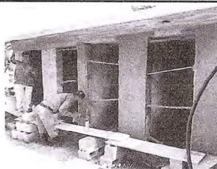
Foto 2: Se evidencia el tallado de puertas de cuatro sanitarios.
